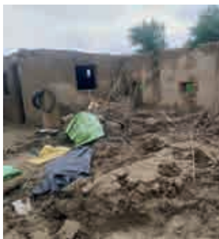
Von der Flut zerstörte Häuser im Ort Chak.
